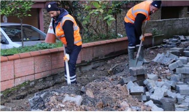
Bahçelievler funda sk yağmur suyu gideri
