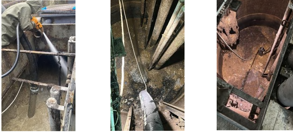
Atıksu Arıtma Tesisi idaresine bağlı Terfi Merkezlerinin (2-3-4-7-8-Tersane, Anka)
